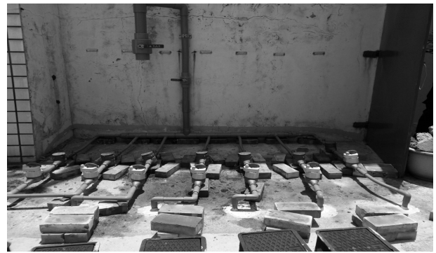
圖 2 T 系統水表及感應器安裝現場
