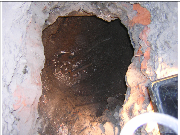
圖十七：在雙層水泥及磚瓦泥土之下，終於找出位於地面下 1.2M 深的接合管漏水。
