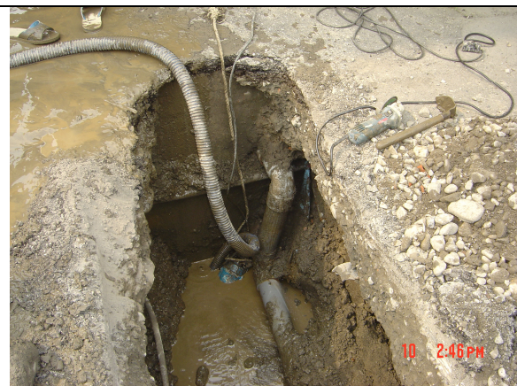
圖七：經分段計量並檢測出的 100mm PVC 漏水管
