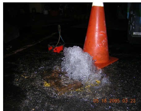
圖十一：大量壓力源水由救火栓冒出
