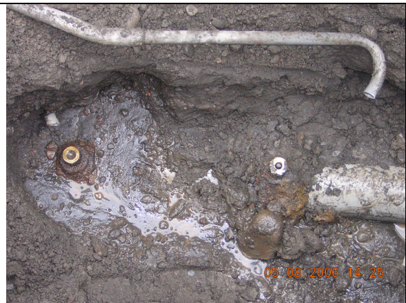
圖六：測試點附近開挖出的不明接合管，經關閉並洽用戶後，一併拆除以杜絕可能的漏水及竊水。
