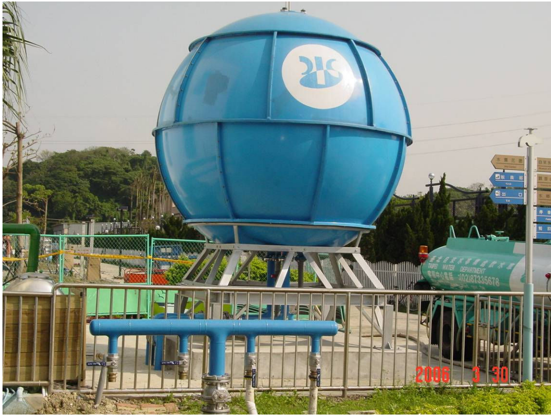
圖 7 公館淨水場維生緊急取水設施照片
