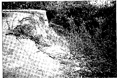
照片 3-2 南 179 道路路基流失
