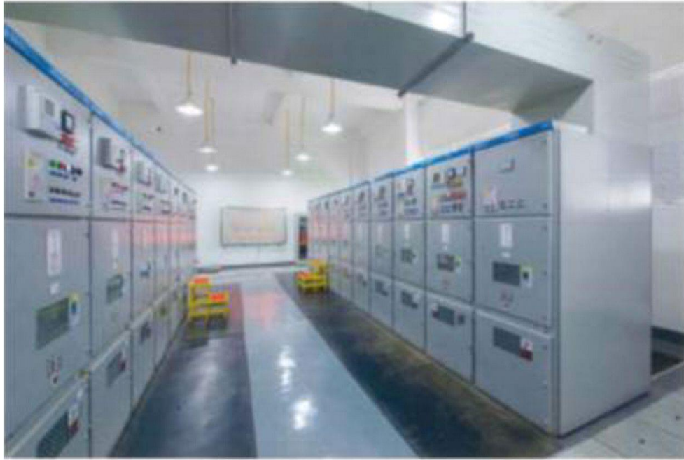
圖 5-11 配水泵房變配電室
