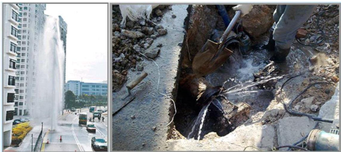
圖 4-51 香港高水壓引致管線爆管與滲漏 [資料 4]
