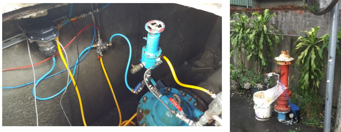
圖 110、I2O 系統現場安裝
