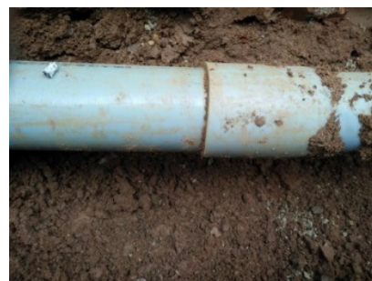
(f) 開挖 F 點 - 接頭點滴漏水
