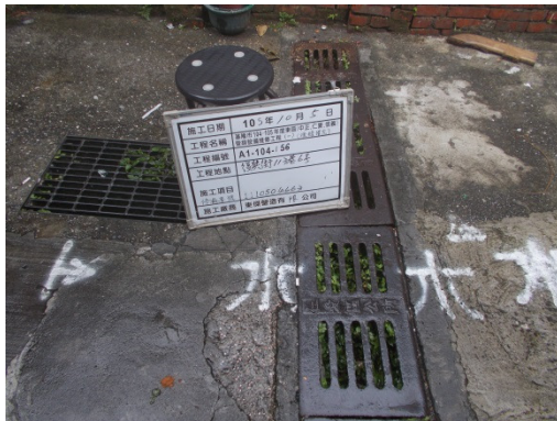
(c) DH 管段(序號 10)地下漏水-開挖處
