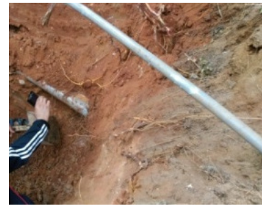
(d) 開挖 D 點 - 接頭漏水
