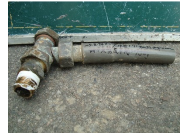
(l) § 20-接合管管套節折斷漏水
