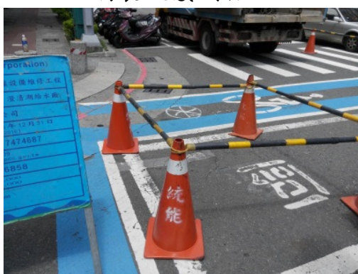
(l) 疑似漏水點噴漆註記
