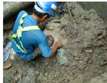
(k)水點開挖中-發現漏水
