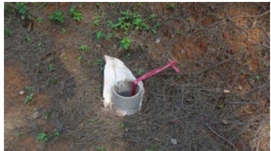
(d)回填後露管利於無線傳輸偵測
