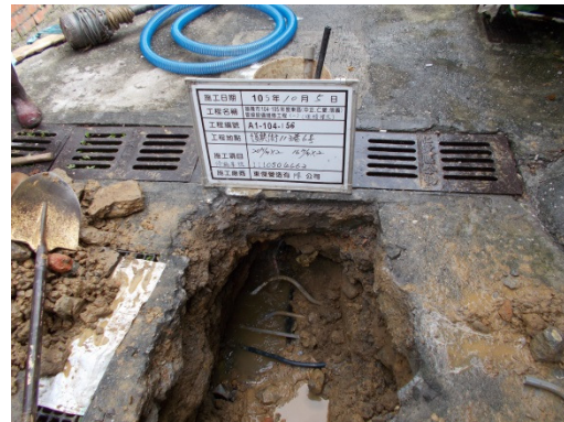
(d) DH 開挖實際漏水點-20PVCP 漏水
