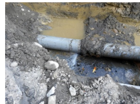
(m) 修漏開挖驗證，係 \phi 200-PVCP 裂縫漏水
