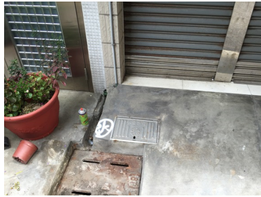
(d) 瑞源路 65 巷 2-1 號溝底漏水 用戶拒修，仍持續溝通並列案追蹤
