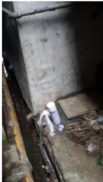
(d)DF 實際漏水點-20PVC 漏水
