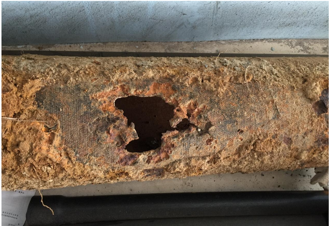
圖 3-6 澎湖地區 DIP 銹蝕情形
