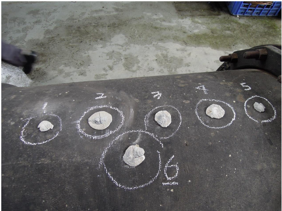
圖4-26 密封塗層經鑽孔後掉落部分
