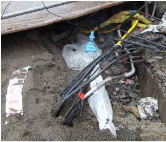
圖 5-47 用戶施工造成斷訊及圖
