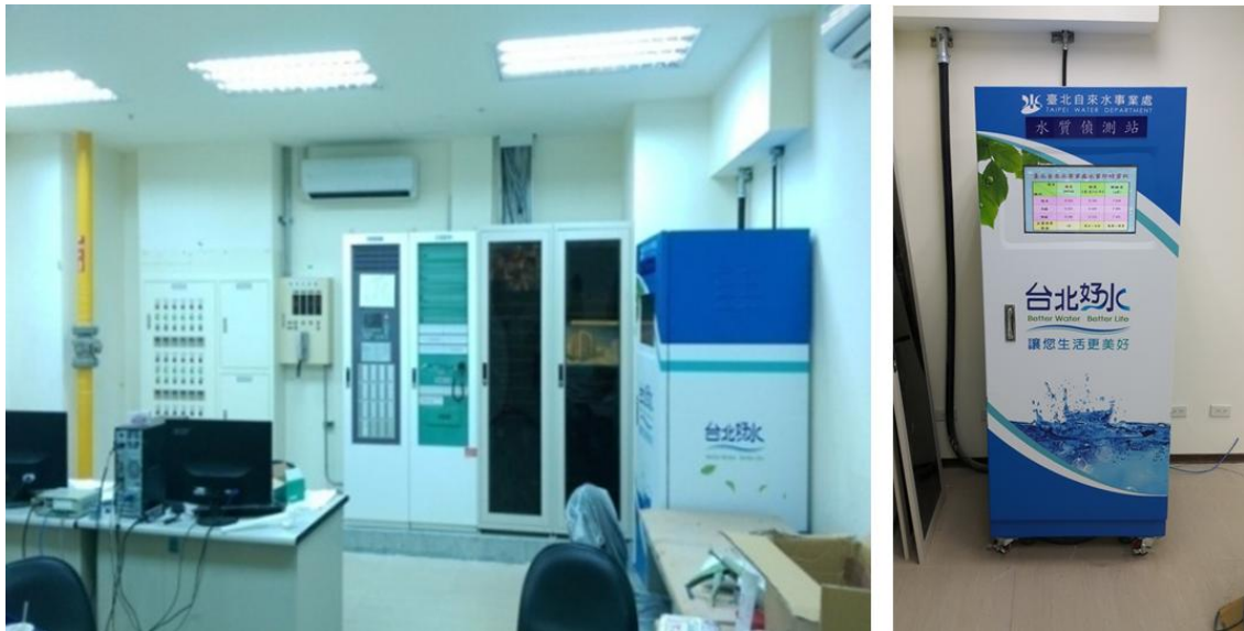
圖 50 水質系統通訊設備箱設置於興隆公宅 1F 防災中心
