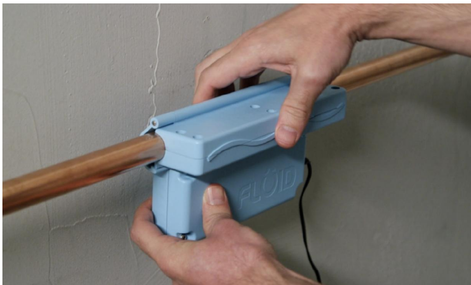
圖 21 表後內線主水管上安裝夾式超音波感應器
