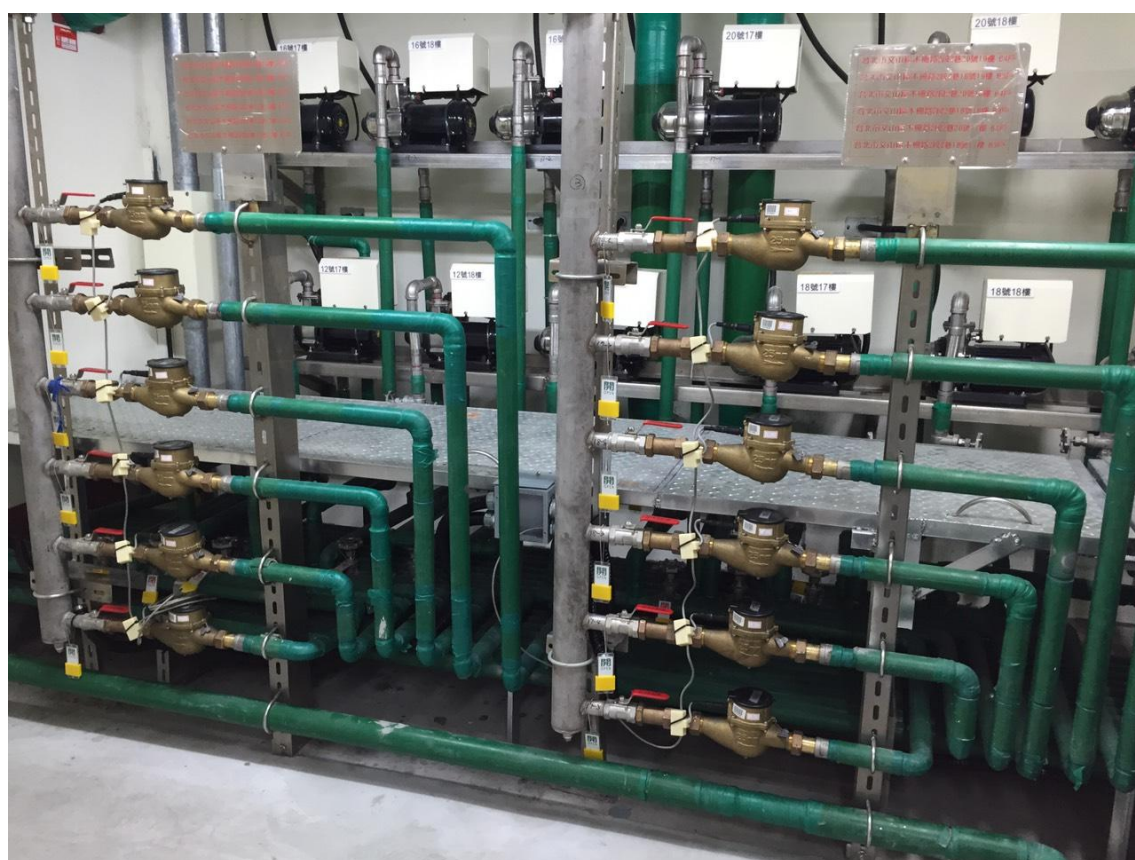
圖 48 興隆公宅頂樓水表室之管路配置與水表安裝有線集抄
