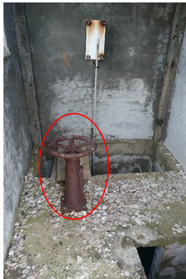
圖 4.4-48 吉貝場濾水控制閥老舊
