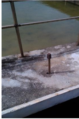
圖 4.1-54 濾水閘門及轉軸
