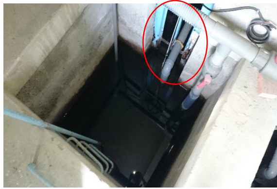
圖 4.4-38 虎尾場濾水溢流堰照片
