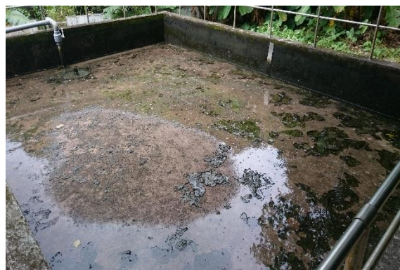
圖 4.4-69 大溪場慢濾池輪替操作現場照片
