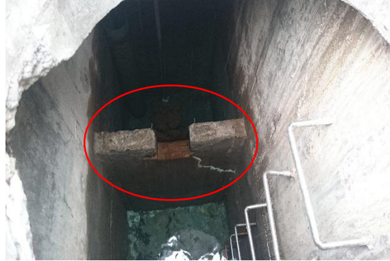
圖 4.4-67 大溪場濾水溢流堰照片
