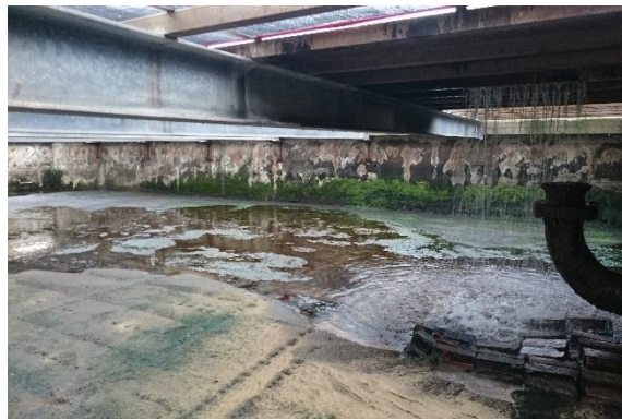
圖 4.4-50 吉貝場慢濾池輪替操作現場照片
