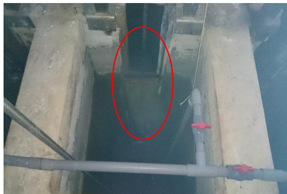
圖 4.4-8 白雲場濾水溢流堰照片
