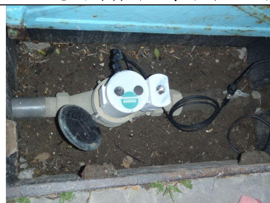
圖 5-33 乙廠商無線讀表現場測試
