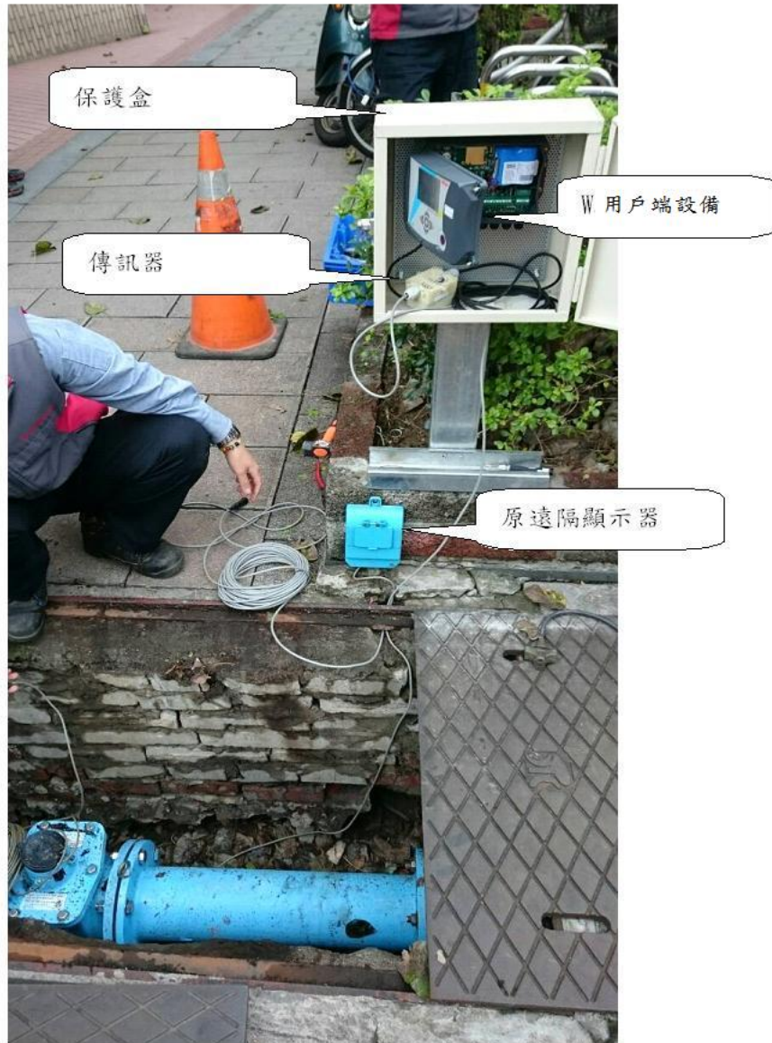
圖 5-1 甲廠商用水管理硬體現場安裝相片
