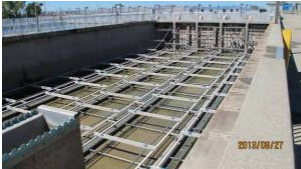
圖 5.1.1-19 Ballman 淨水場沉澱池括泥機
