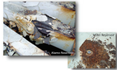
圖 5.3.1-13 鋼製儲水槽損壞狀況
