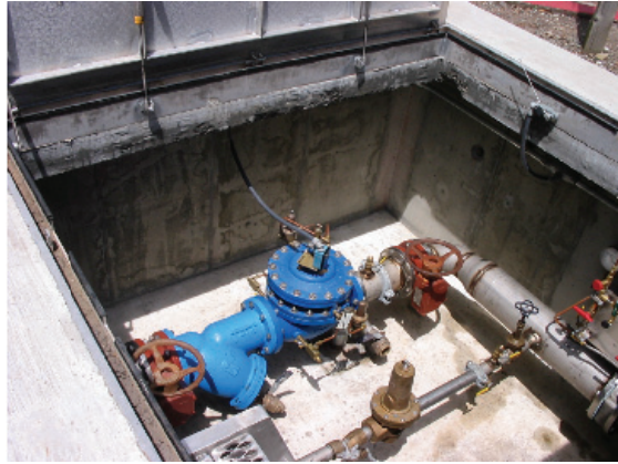
圖 5.4-4 壓力調節閥照片
