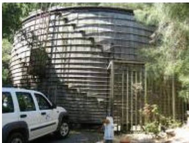
圖 5.3.1-6 紅木製儲水槽
