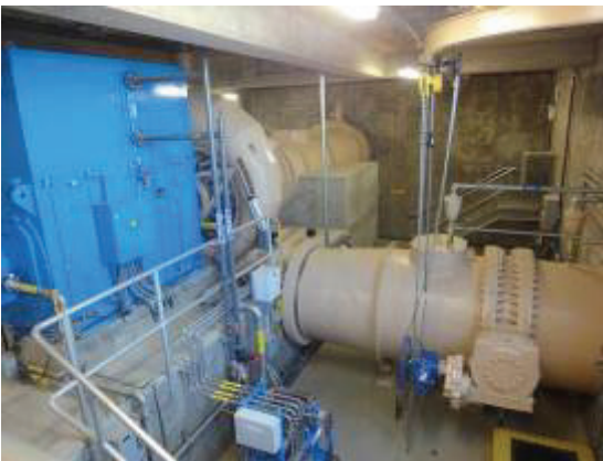
圖 5.1.1-15 中繼 hydro 水力發電設備
