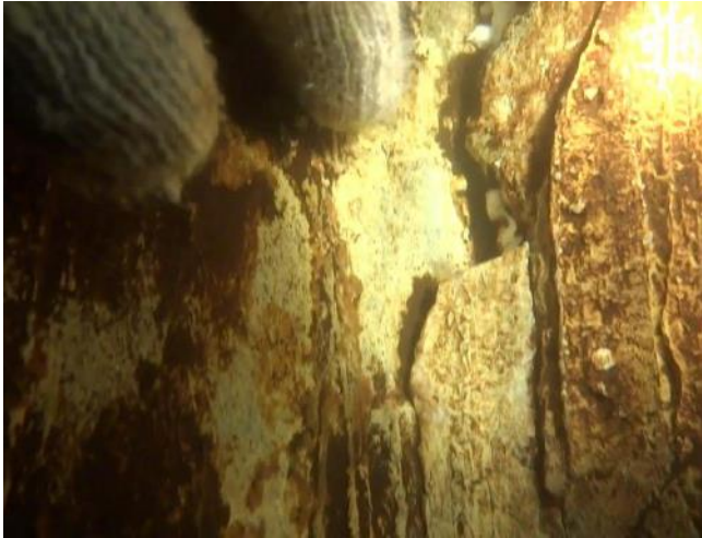
3.舊有伸縮縫老化龜裂
