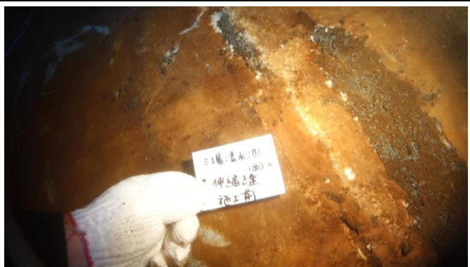
4. 池內伸縮縫老化、龜裂
