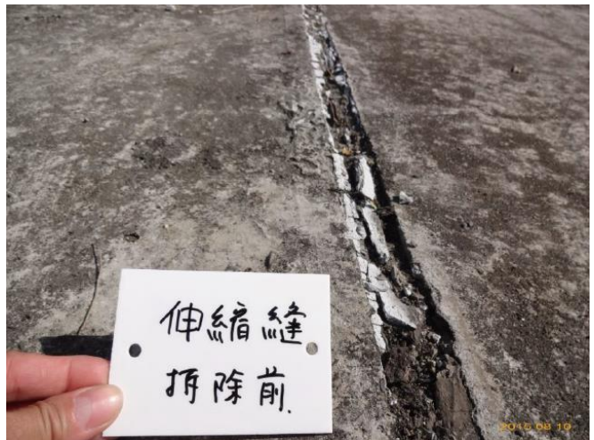
10.池頂伸縮縫龜裂情形
