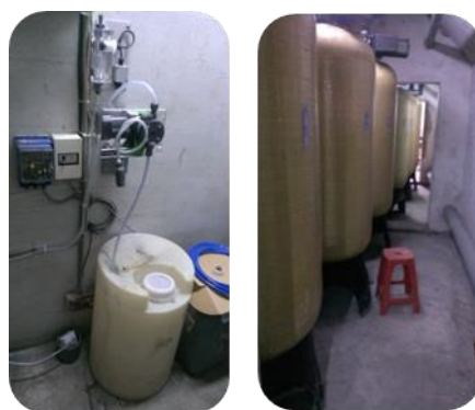
圖 69 馬偕醫院戰備水井及相關設備現勘照片
