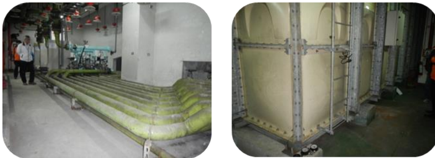
圖 66 訪查醫療院所用設備容量照片
