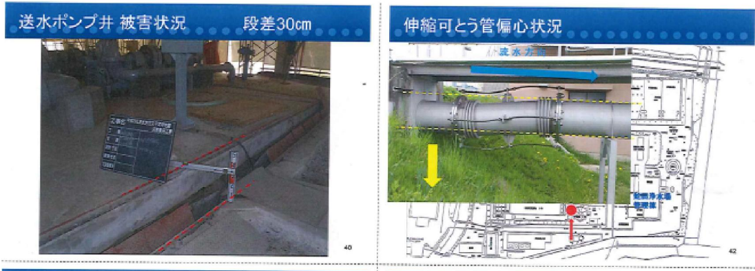
圖三十三：自來水設施損壞情形
