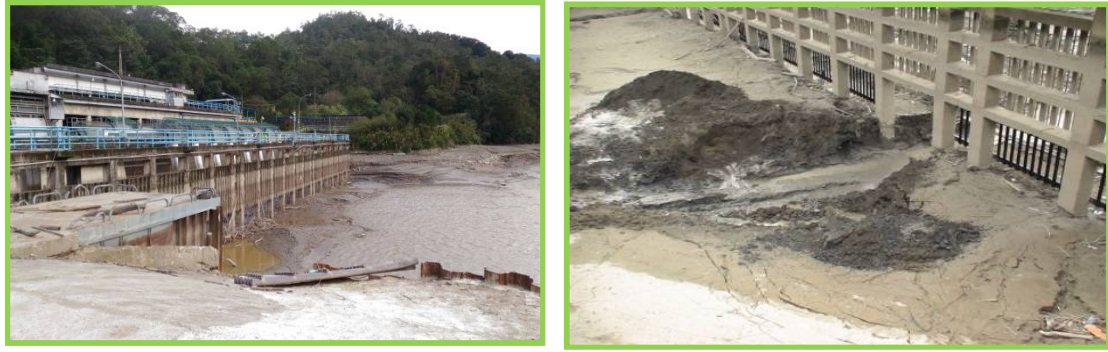
圖 2-21 一原取水口嚴重淤積
