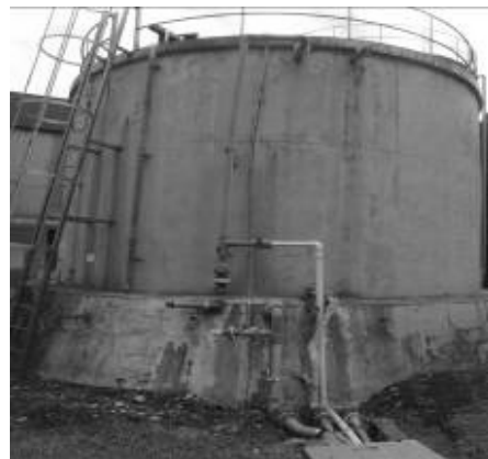
圖 1 100 噸氫氧化鈉(NaOH)藥槽 3 槽已老舊逾使用年限，槽體膨脹嚴重變形
