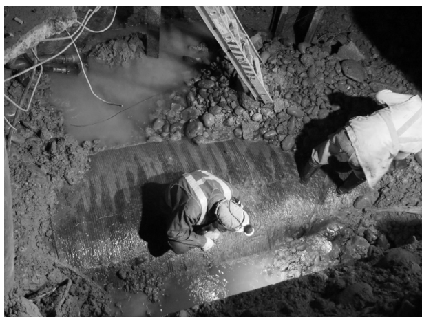
圖 1 \phi 1750\text{mm} PSCP 鋼線外露斷裂漏水
