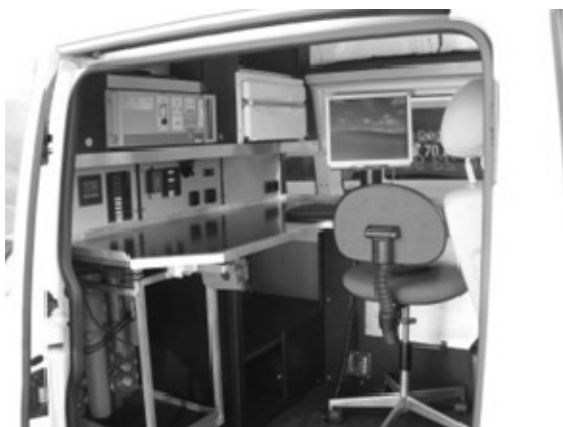
圖 6 丹麥檢漏裝備車資訊設備
