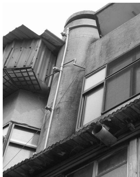
圖 4 用戶改裝後之下水管（明管）
