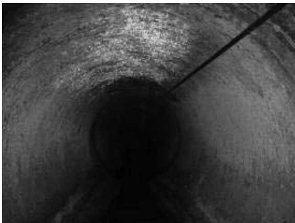
圖 15 下水道箱涵漏水已改善(斷管後)
