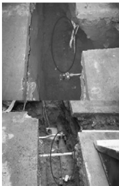
圖 5 用戶改裝後之下水管(明管)
