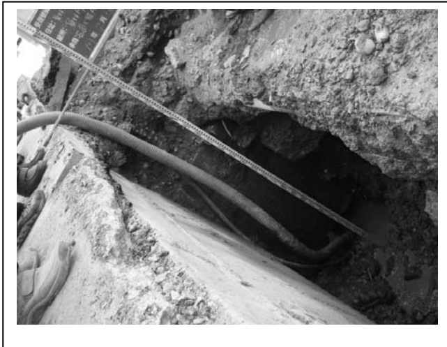
圖 3 管深超過 3.5M 位排水溝底下無法深挖
