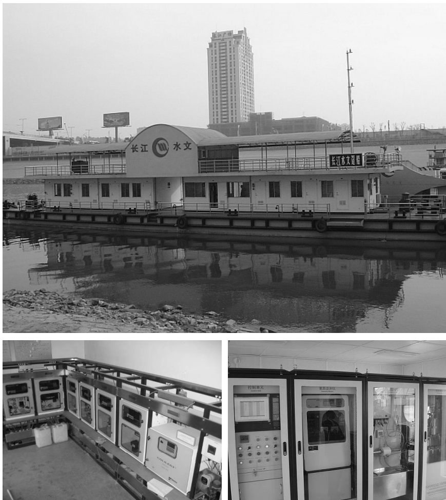
圖 6 武漢自來水廠取水站及傳統水質監測設備
