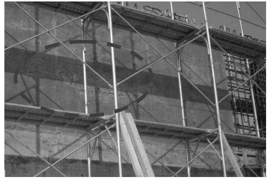
圖 5 清水池池牆未以 4 吋鋼管澆置產生之蜂窩現象
