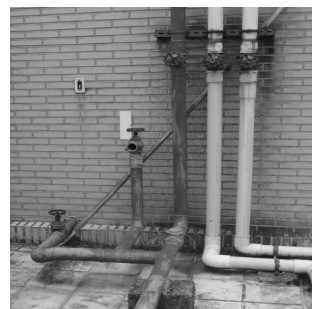
水塔連接消防取水口
