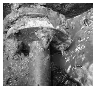
A2 棟總表後由令漏水
