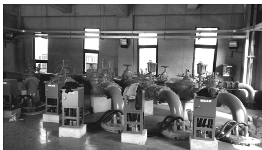
圖 2 新南港加壓站抽水機
