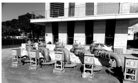
圖 3 舊南港加壓站抽水機
