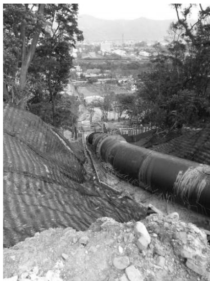
圖 18 爬坡段倒塌缺失遭停工改善後
