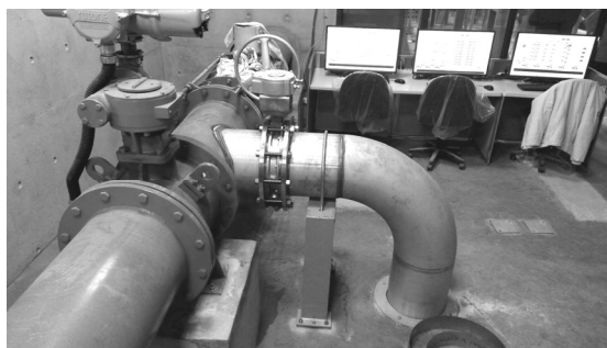
圖 9 新設回流儲槽管道照片
