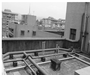
相鄰棟水塔經消防管相通
