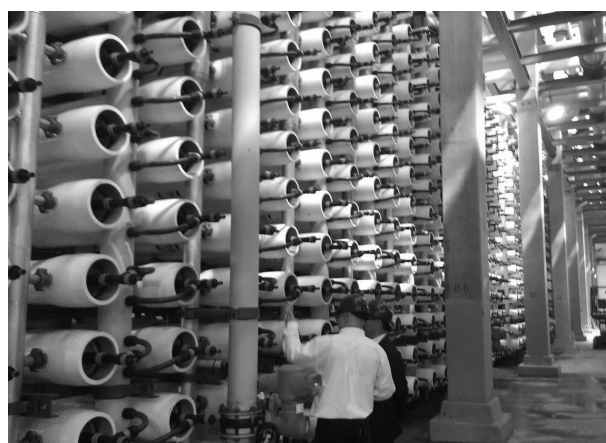
圖 1 逆滲海水淡化廠
