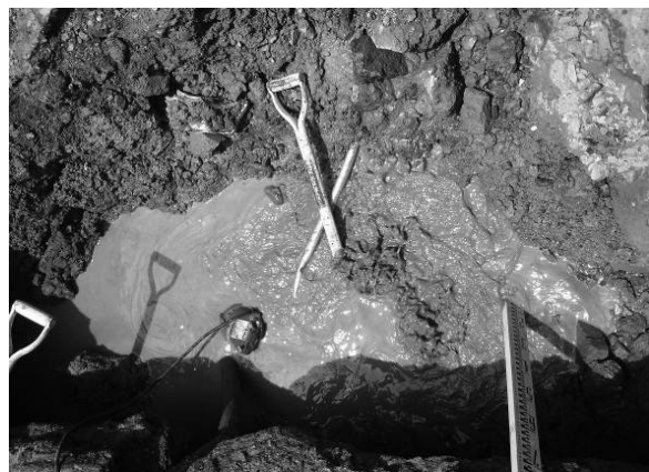
圖 12 華潭街 1 巷 75 號前開挖發現漏水
