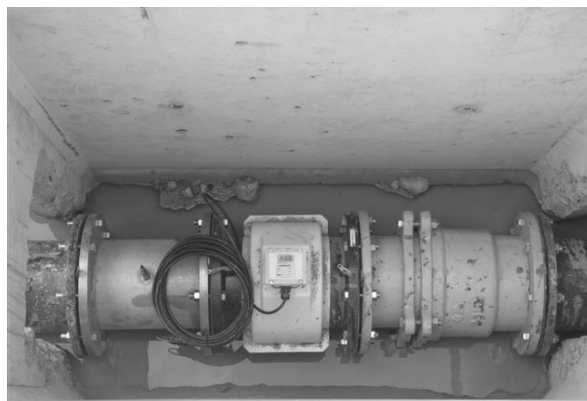
窰井內水表組組裝完成
