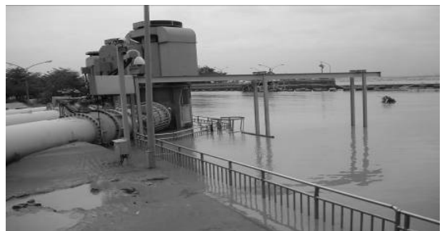
照片 1 高屏溪攔河堰沉砂池照片
