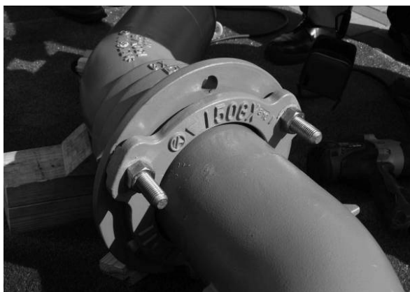
圖 29 彎管壓圈只用 3 支螺絲固定
