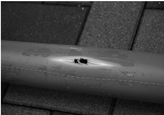
圖 15 PE 管遭管內壓撐破後的情形（如魚嘴般的破洞）
