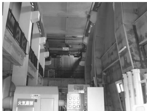
圖 45 淨水設備廠裡面的柱嚴重扭曲
