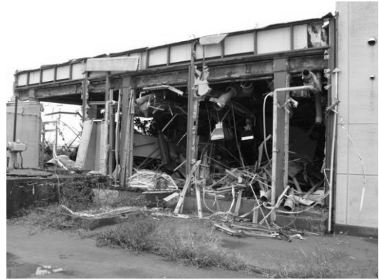
圖 43 仙台市汙水處理廠遭海嘯嚴重破壞
