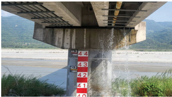
圖 5 米棧大橋管線漏水
