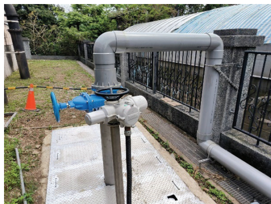
圖 7 新下竹林配水池重力進水電動閥
