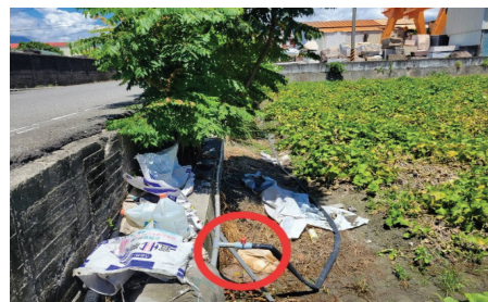
圖 6 外線 25mm 附著於水溝外側明管佈放，水表前端遭菜園私接
