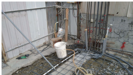
圖 9 建築工地之殘存管，遭私接竊水
