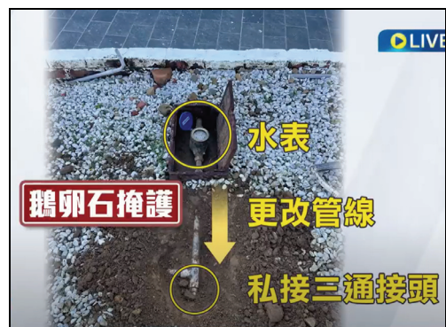
圖 3 測試出給水栓竊水，複查水表前 1 公尺處私接三通接頭
