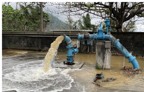
圖 10 緊急啟動新興淨水場備援水井設備
