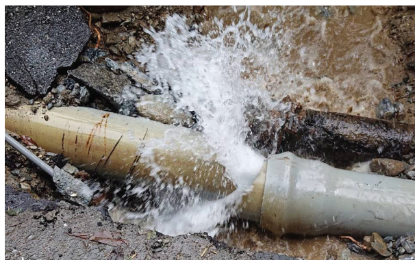
圖 3 富世淨水場取水口導水管斷裂漏水
