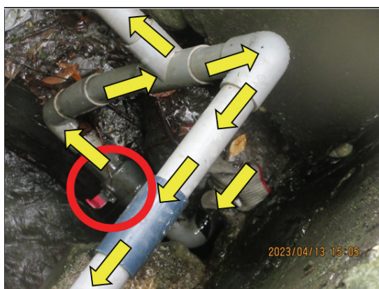
圖 4 私接台水 \phi 50 管線混接入水澗水管線系統，供水販售長達 24 年
