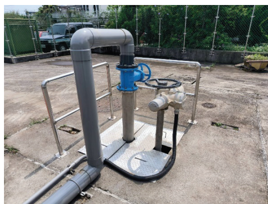
圖 6 永嶺配水池重力進水電動閥
