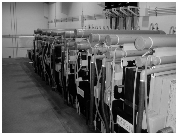
(a)電透析離子交換薄膜機組
