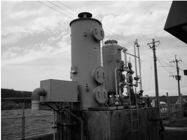
(a)除鐵氣曝設備
