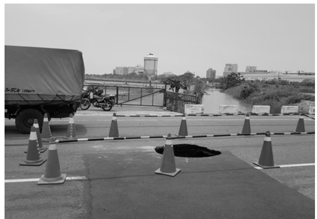
圖 2 路面掏空現場照片
