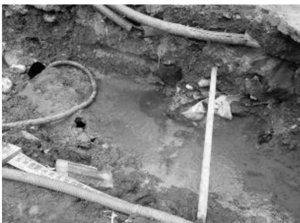
圖 8 捷運工地嚴重漏水
