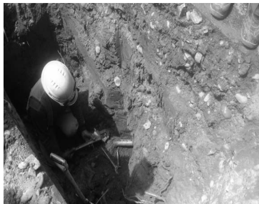
圖 9 開挖發現 40mm 管線
