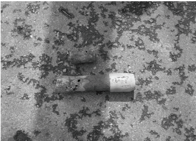
圖 14 腐蝕大小漏水孔 22 處
