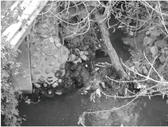
圖 13 田尾村五爪路口漏水處
