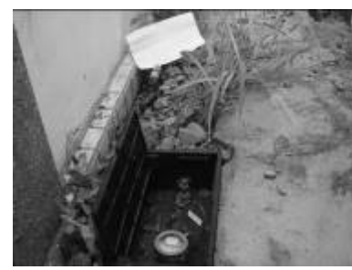
圖 12 私接戶自行切除竊水節點
