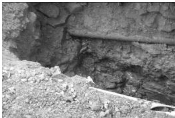
圖 16 開挖面北側不明水流
