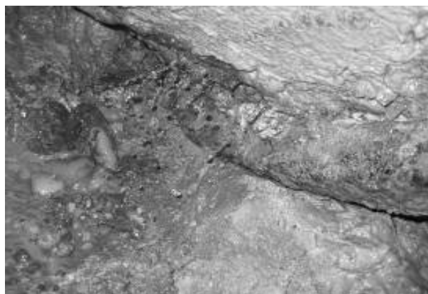
圖 21 白口下緣漏水情形
