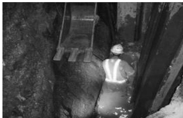
圖 20 檢視接頭漏水情形
