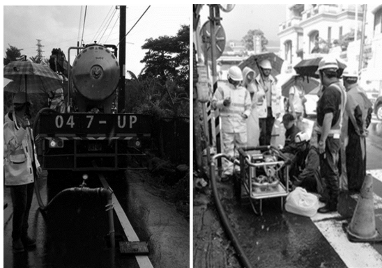
圖 16 入口處注冰及出口處碎冰排出
