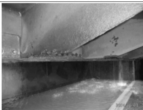
圖 4 排砂道閘門門扉鏽蝕情形
