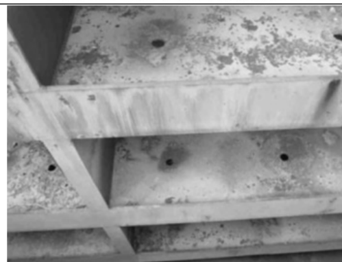
圖 5 排洪道閘門門扉鏽蝕情形
