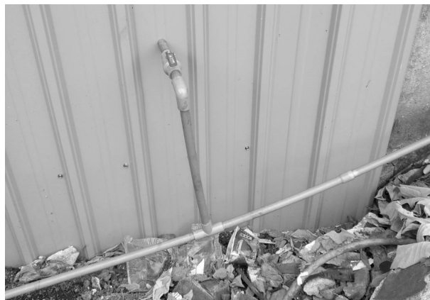
圖 3 A 地水管支管照片
