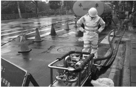
圖 14 出口處連結監測設備排水
