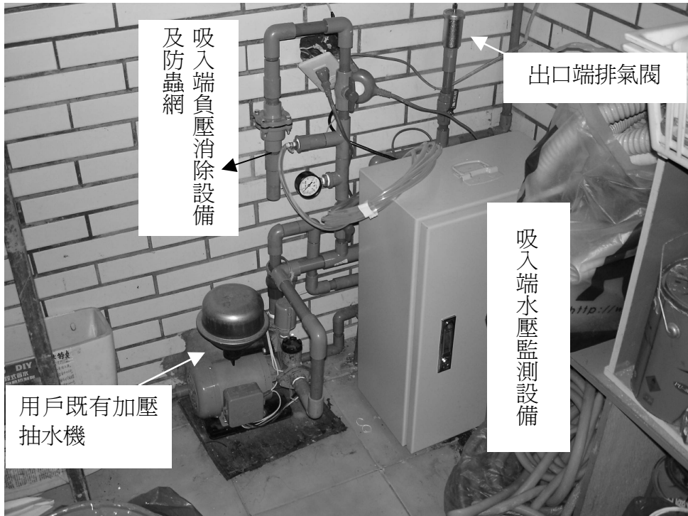
圖 9 馬達直接抽水負壓消除設備及水壓監測設備
