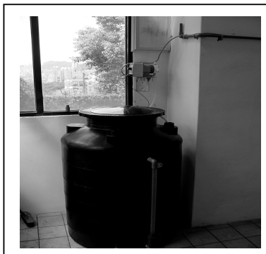
圖 6 木柵二期配水池漂水加注補充系統現場設備圖
