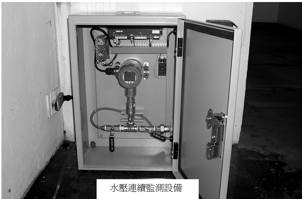
圖 5 用戶端水壓連續監測設備
