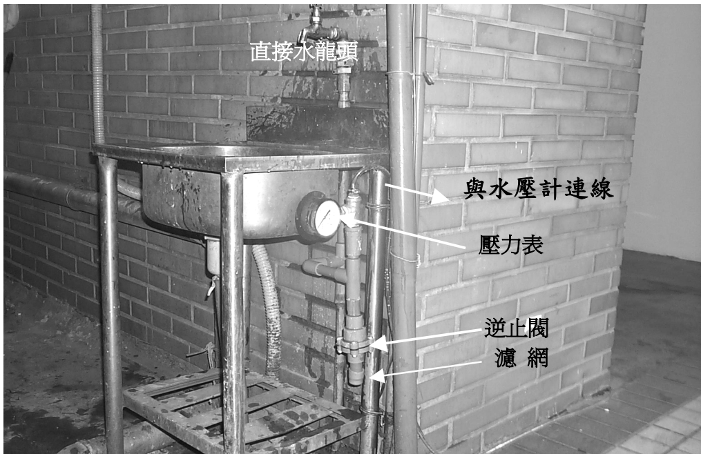
圖 4 用戶表後加裝負壓破壞設備
