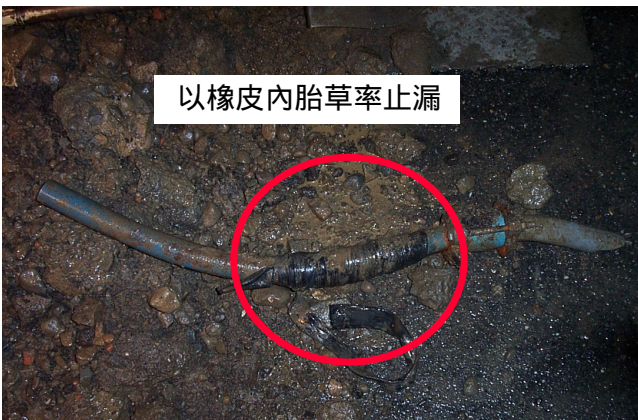
圖 10 施工挖損漏水
