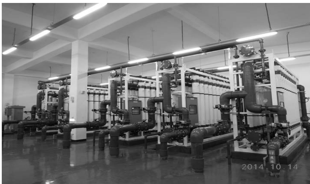
UF 超濾系統設備
