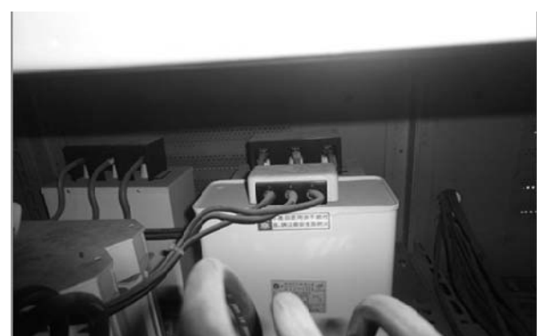
圖 8 功率因數調整器，改善後維持場內功因平均 97% 並增設電容器
