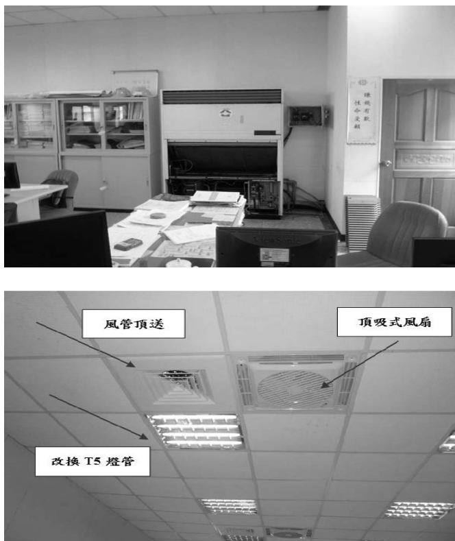
圖 10 風管頂送、頂吸式風扇及 T5 省電燈管
