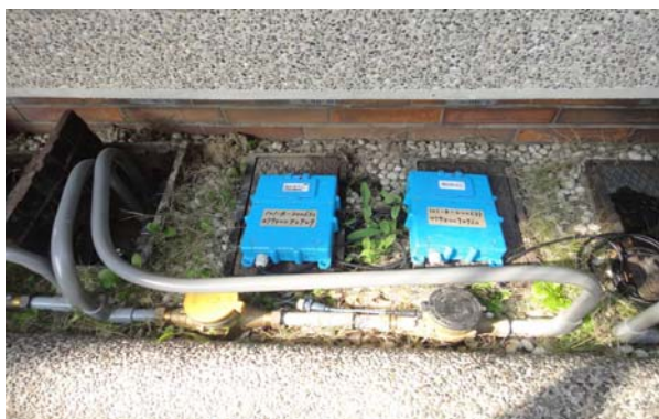
圖 1 水量計 B 及 C 級現場安裝圖
