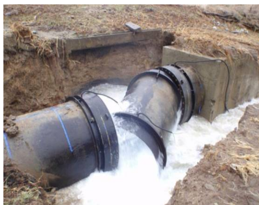
圖 3 東北大地震( \phi 2.4M 幹管斷裂)
