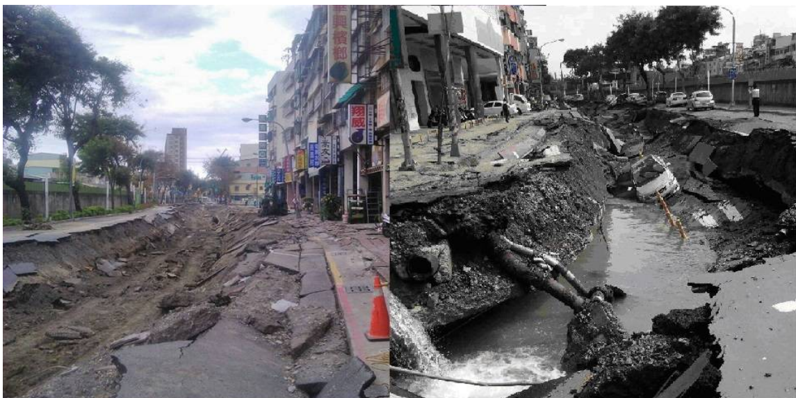
圖 2 凱旋三路 \phi 400mm 送水管線損壞照片
