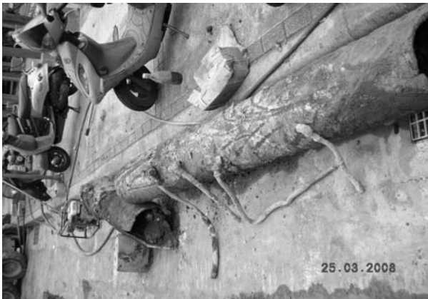
圖 5 長沙街萬華 406 號空地前 MJP 管舊有鉛管接水點
