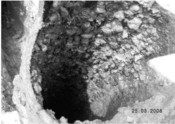
圖 4 長沙街萬華 406 號空地前舊有 MJP 管鏽蝕情形
