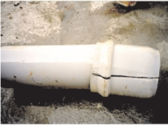
員林鎮中正路200號前250mmPVCP接頭破裂
