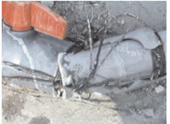
石岡鄉石岡壩管理局路口50mmPVCP接頭變形彎曲斷裂
