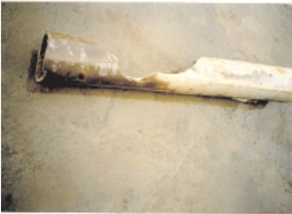
員林鎮崙雅巷5-35號前80mmPVCP破裂
