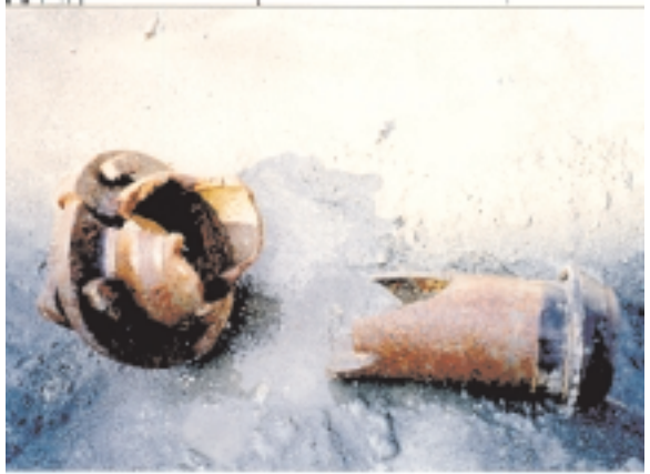
員林鎮員水路一段440巷31弄口80mmCIP直管及接頭破裂
