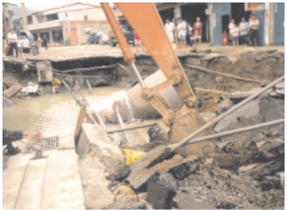
頭份鎮水源路447號前1350mmPSCP折斷
