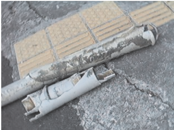
卓蘭鎮和平街斷層段100mmPVCP互插破裂
