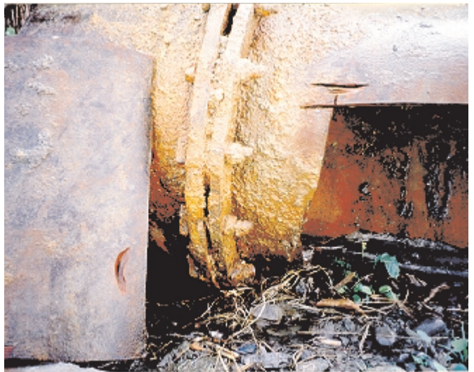
▲員林鎮員水路259號前500mmDIP破裂
