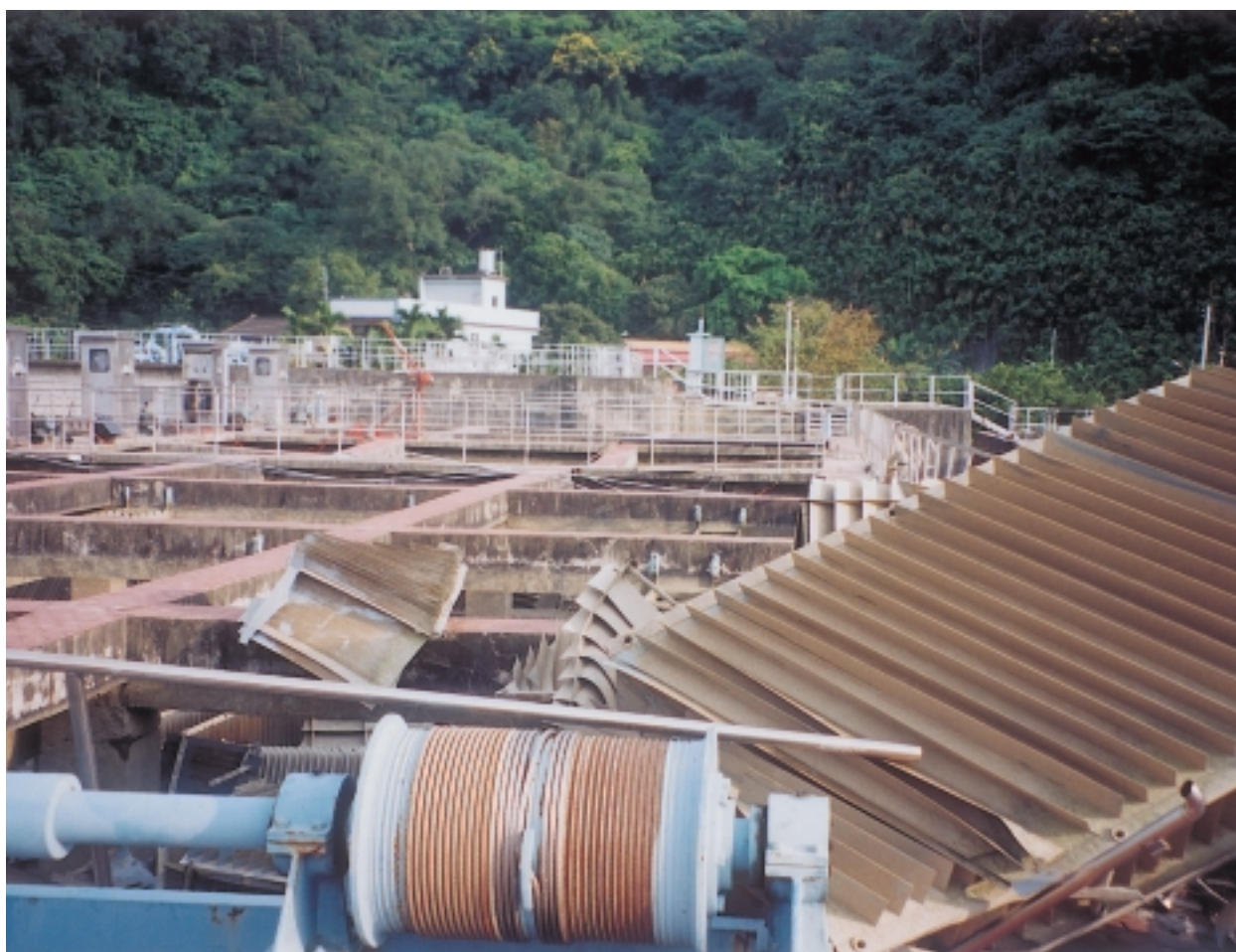
豐原給水廠—淨水場「九二一地震」災損情形
