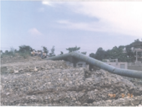
台中縣太平市一江橋1000mmSP過橋管線變形脫接
