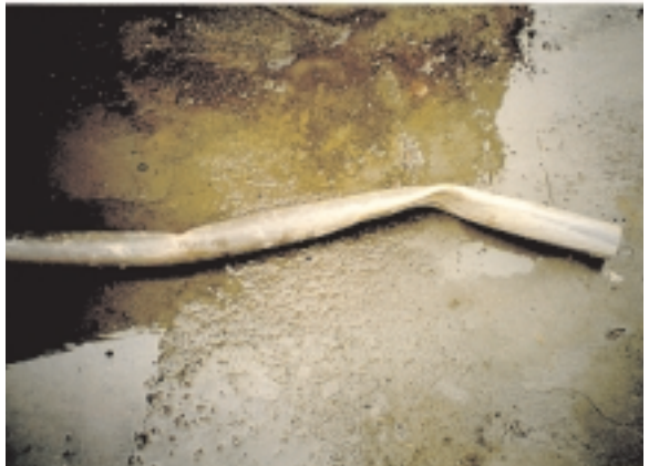
員林鎮崙雅巷2-38號前40mmPVCP變形
