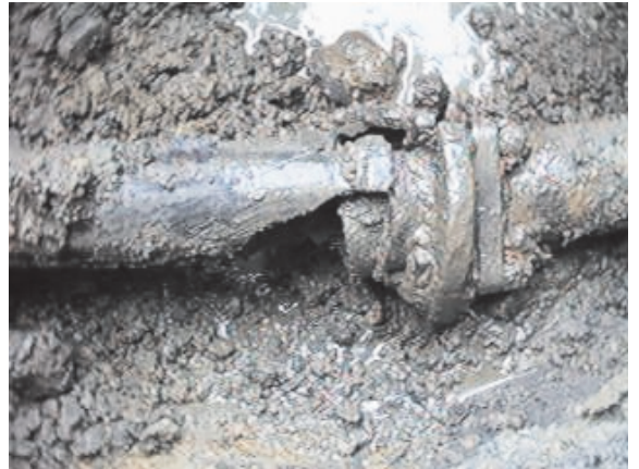
卓蘭鎮食水坑區100mmDIP接頭兩側破裂
