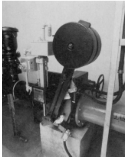
圖-3.4.21 信號式緊急遮斷閥使用例 口徑 200 mm 150 mm 以偵測震度與流量方式控制 動力來源為自重 (靜岡縣庵原郡富士川町 吉津配水池出水管)
