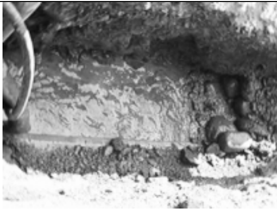
圖十四：PVC-PE 受卵石（右側）擠壓致漏水
