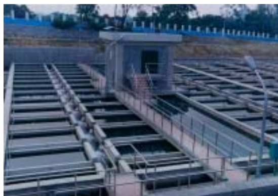
澄清湖淨水場新設膠凝沉澱池Pulsatube
