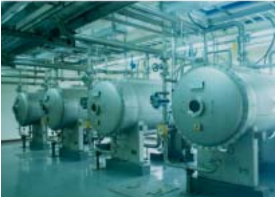
澄清湖淨水場新設臭氧產生機Ozone Generator
