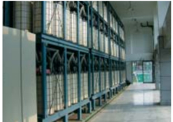
翁公園淨水場超微過濾設備 Ultrafiltration(UF)
