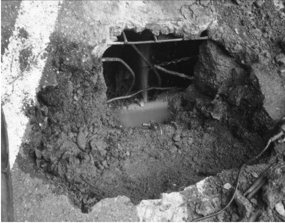
圖 19 給水管線與水溝壁平行疑遭施工損毀修復不良-1
