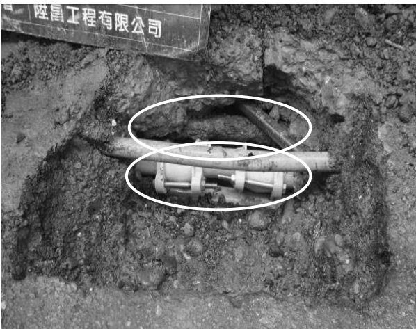
圖 14 本處多支給水管線及配水管平行佈設且與其他管線單位平行-2
