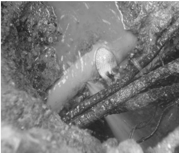
圖 20 給水管線與水溝壁平行疑遭施工損毀修復不良-2
