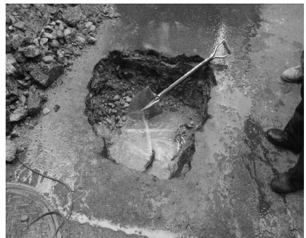
圖 18 管線老舊 PB 管線及修復不良
