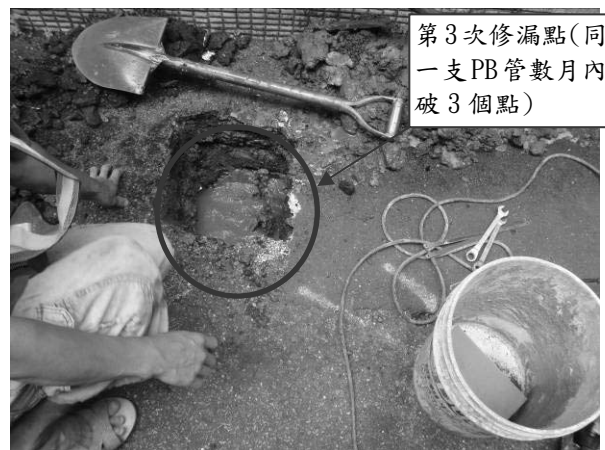
圖 10 PB 劣化漏水(1,2,3)
