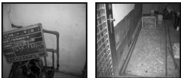
圖 12 屋內內線以暗管配置情形（一）
