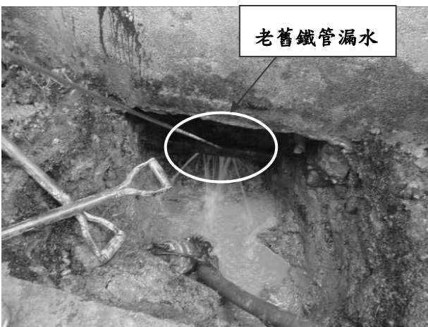
圖 15 管線老舊漏水-1
