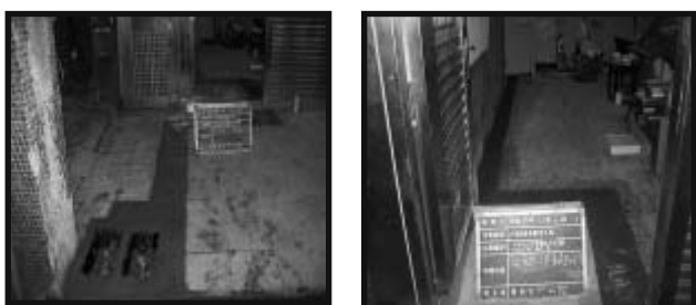
圖 13 屋內內線以暗管配置情形（二）
