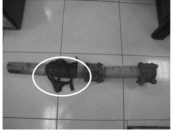
圖 22 配水管與電信電力管線重疊埋設疑遭施工損毀修復不良-2
