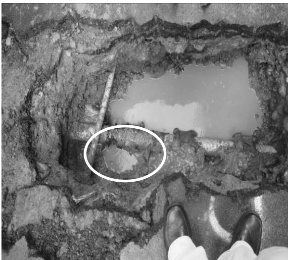
圖 21 配水管與電信電力管線重疊埋設疑遭施工損毀修復不良-1
