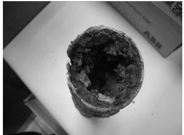
圖 17 管線老舊漏水-3
