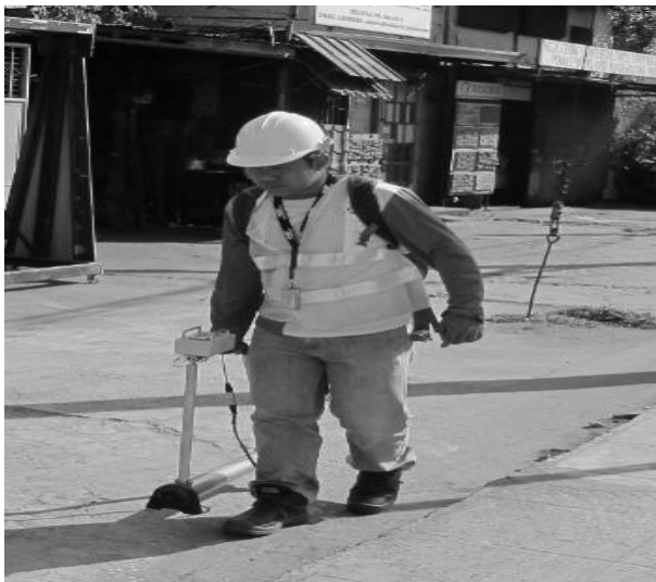
圖 8 追蹤位於管路中之勘測裝置
