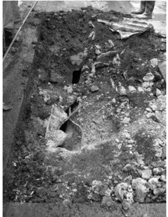
圖 9 管線遭排水箱涵覆蓋
