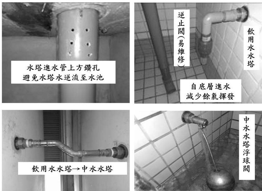
圖4 臺大環研大樓飲用水水塔水質滯留改善
