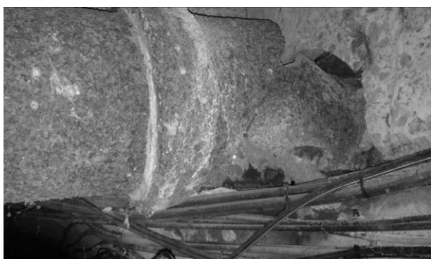
圖 6 臺北市基隆路二段 172 巷口舊管已破損
