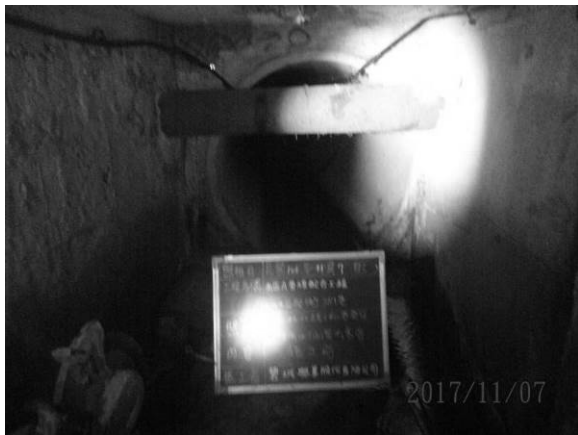
圖 27 吳興街 381 巷管線穿越情形
