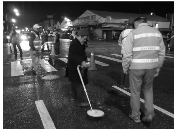
圖 5 道路平整政策，制水閥盒下地後，需經探測、開挖，阻礙且遲緩了救災的時間
