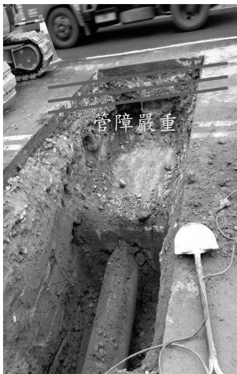
圖 8 新店區中正路 400mm 自來水管穿越箱涵情形
