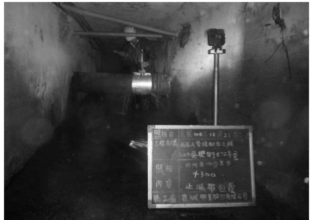
圖 29 誤判為空管切除以止漏帶止漏另行改管
