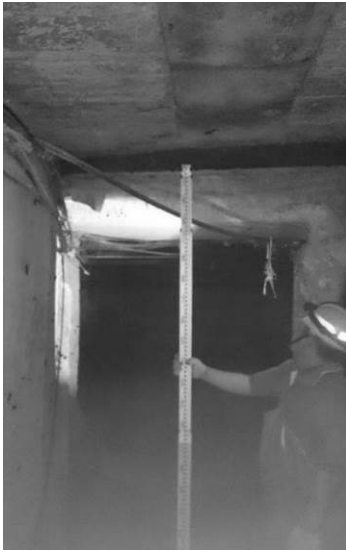
圖 30 富陽街管線穿越位置較箱涵橫樑為高
