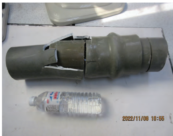
圖 12 富里鎮寧 60 號側- \phi 110-ABSP 接頭擠壓破裂
