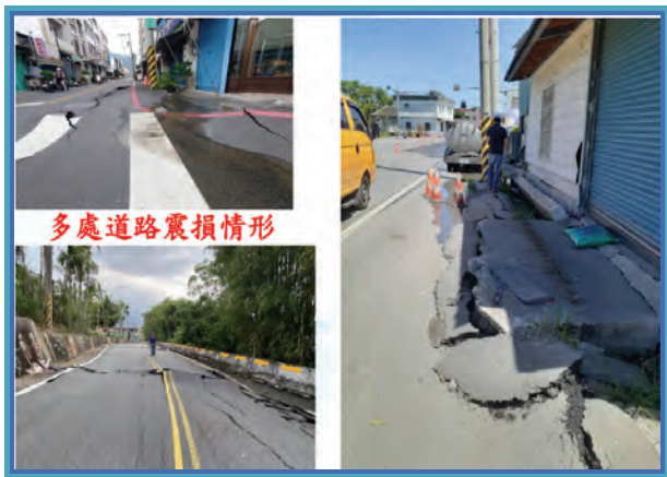
圖 2 地震造成多處道路震損情形
