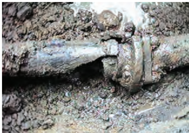
圖 4 卓蘭系統 \phi 100-DIP 接頭碎裂
