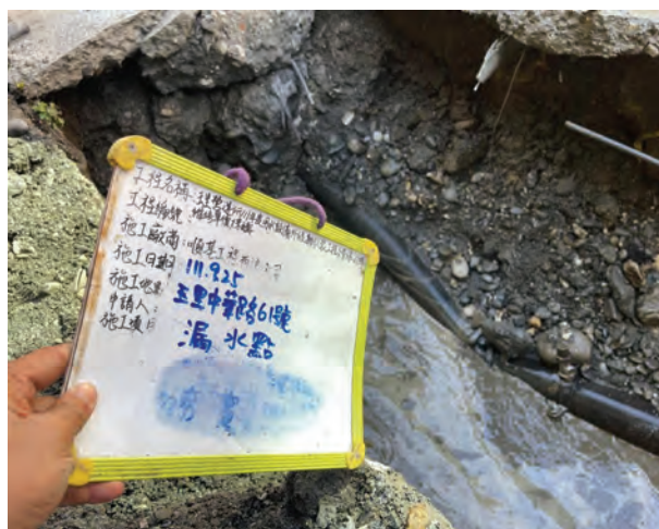
圖 13 玉里鎮中華路 6 號 \phi 100-DIP 折裂
