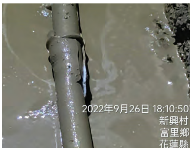
圖 10 富里鄉新興村(77 線) \phi 100-PVCP 接頭破裂
