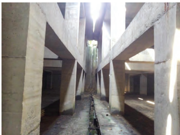
圖 2 RC 水池之池頂、池底伸縮縫損壞
