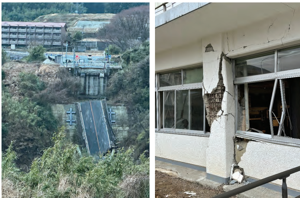
圖 10 熊本地震橋樑及房舍災害遺跡情形
