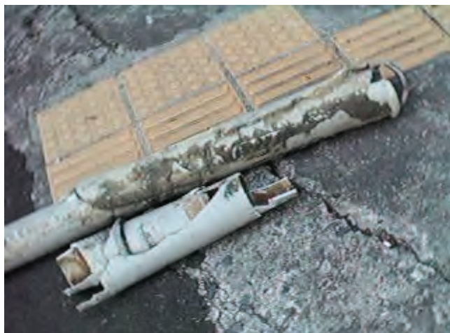
圖 1 卓蘭系統 \phi 100-PVCP 內插破裂約 1 公尺長
