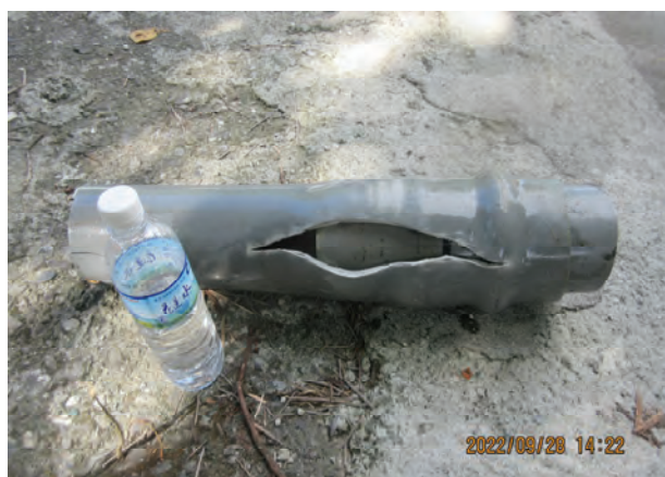
圖 11 富里鎮寧 60 號前- \phi 110-ABSP 接頭擠壓破裂
