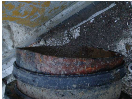
圖 8 拆除 \phi 700 舊管切割面不齊
