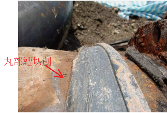
圖 7 拆除舊管之膠圈遭切削
