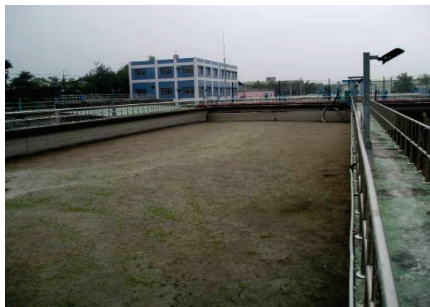
圖 1 翁公園沉砂池淤積照片
