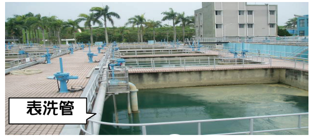
圖 10 烏山頭給水廠綠葉式快濾池表洗管照片
