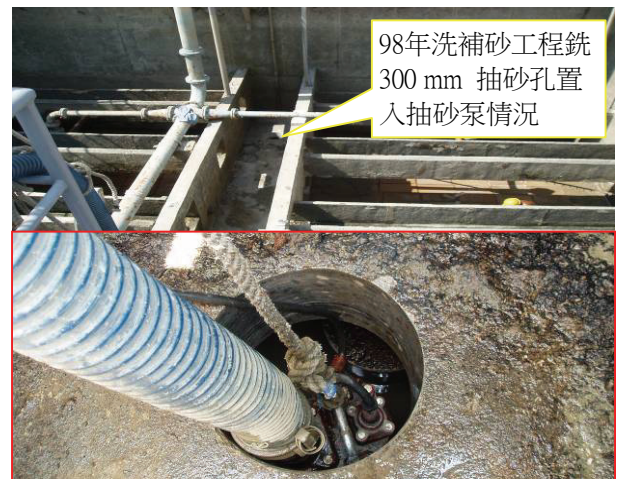
圖 13 反洗廢水渠照片
