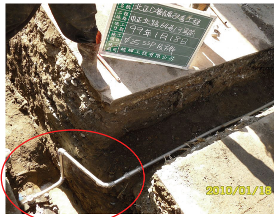
圖 10 以波狀管施工毋須設置三彎頭，應避免以波狀管做三彎頭使用
