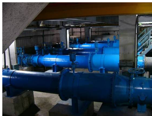
圖 9 中和加壓站沉水型抽水機(汰換後)
