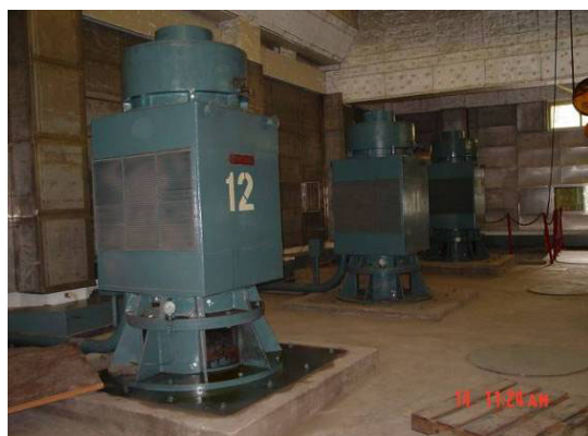
圖 8 大同加壓站豎軸型抽水機(汰換前)
