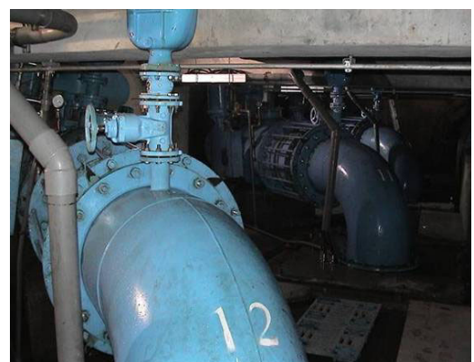
圖 10 大同加壓站沉水型抽水機(汰換後)
