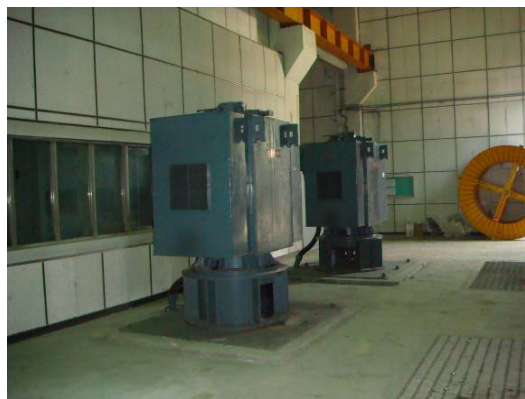
圖 7 中和加壓站豎軸型抽水機(汰換前)
