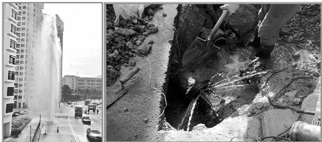
圖 29 香港高水壓引致管線爆管與滲漏
