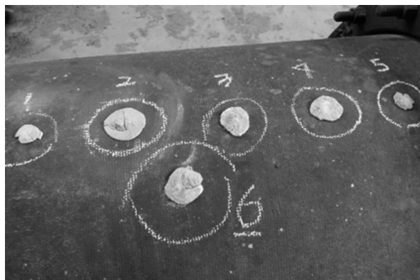
圖 11 密封塗層鑽孔後剝落情形
