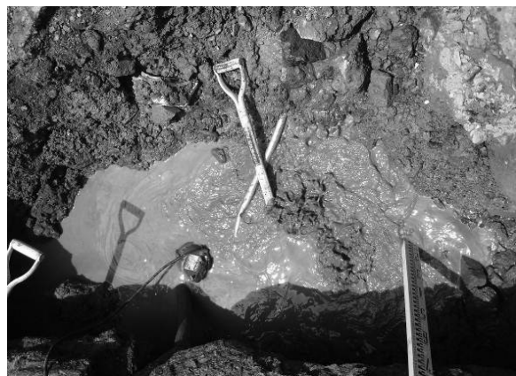
圖 12 華潭街 1 巷 75 號前開挖發現漏水
