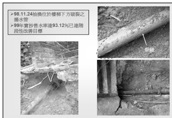
圖 9 \phi 100\text{mm} PVCP 揚水管底部裂縫照片
