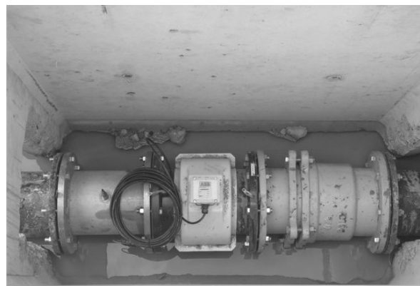
窰井內水表組組裝完成
